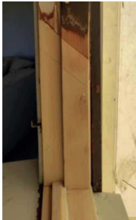
Där träet blivit för dåligt i utsatta delar i karmar eller bågar har nya stycken av senvuxen kärnfuru kunnat fällas in, som här på bilden i bottendelen av en stående karm. Det äldre träet ansluter snedskuret upptill genom laskning. Det mörka utgör nedslipad äldre kulör.
