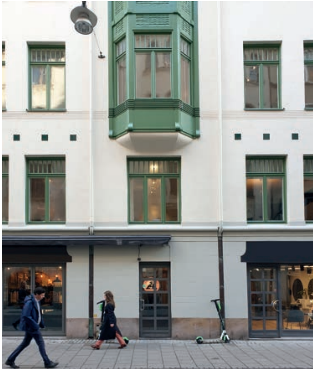
Färdig fasad – återställt burspråk i trä med vågmönster. Lägg märke till de två omgivande symmetriska stuprören, som varit ett grepp i gestaltningen av fasaden från början.
