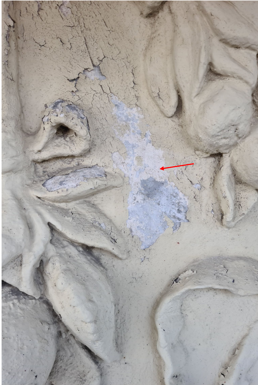
Närbild på den ursprungliga stuckfrisen, innan den togs ner. Den röda pilen pekar på rester av den ursprungliga bemålningen i en varmbeige ton. (Den kimröksgrå kulören därunder är en pigmentering i gipsstucken, på grund av de utfyllnadsmaterial som användes vid stucktillverkningen i slutet av 1800-talet.) Det yttersta färgskiktet består av en modern färgtyp, med en kulör som påminner om den ursprungliga. Färgen har dock åldrats fult och är för tät för underlaget.
