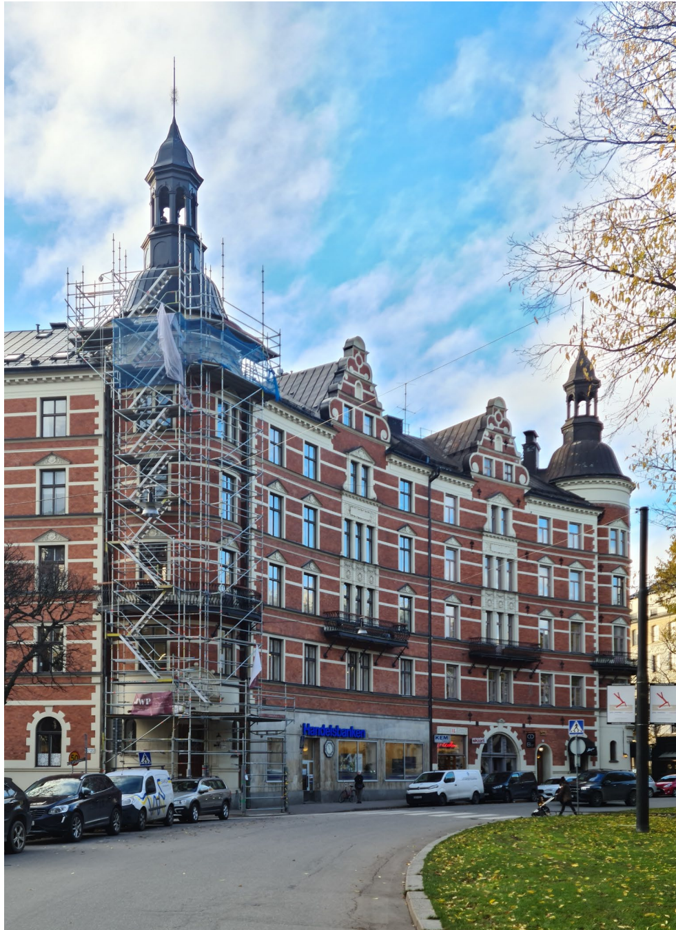
Vy mot de båda systerbyggnaderna mot Karlaplan, med det aktuella hörtornet i förgrunden. Stuckfrisen ses bakom den blå väven högst upp på ställningen. Bilden är tagen 20 november.
