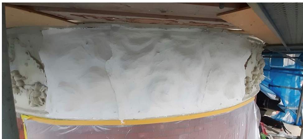
Hela rapporten är täckt av en gipskappa, som senare togs till verkstaden. Foto: Daniel Hillman.
